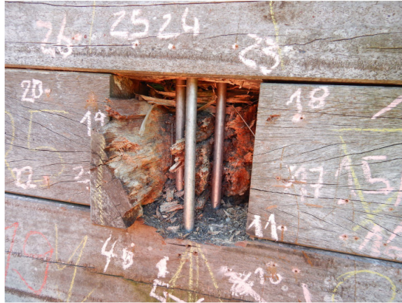
Abbildung 18: Schaden am Längsträger insbesondere um die senkrecht im Träger befindlichen Stabdübel
