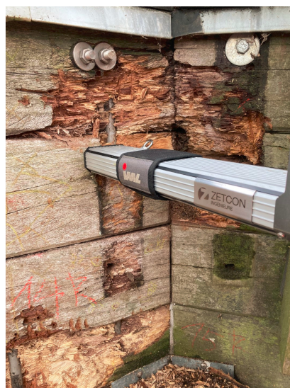
Abbildung 14: Bohrwiderstandsmessung – sehr ausgeprägte Schäden im Bereich der Stabdübel (die mit Radar zerstörungsfrei lokalisiert werden können)
