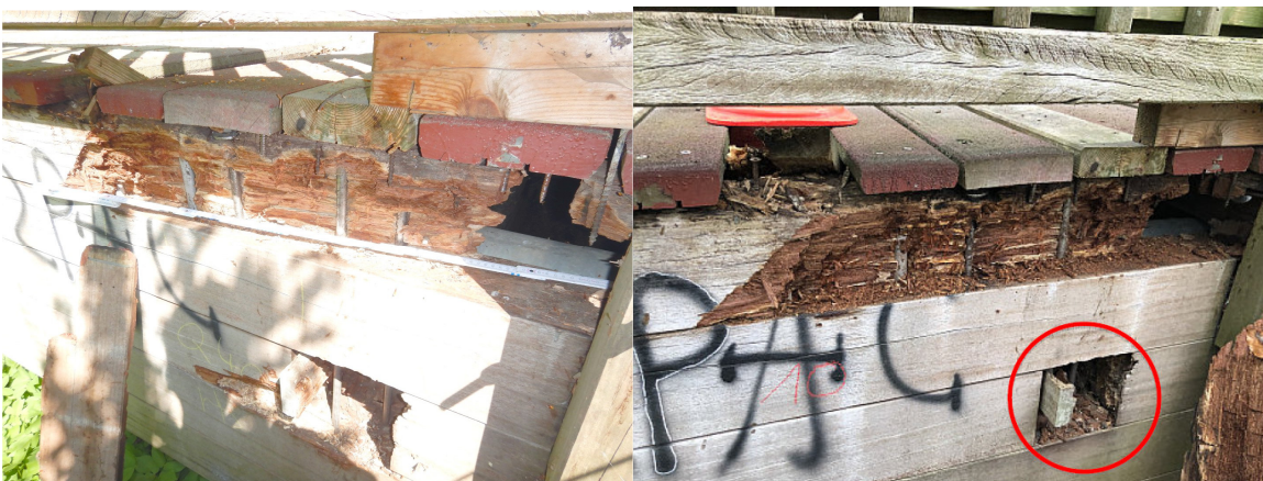
Abbildung 17: links: Schaden an Träger, Belag teils erheblich geschädigt, neu ersetzte Bohlen auf offensichtlich stark geschädigten Träger befestigt rechts: Haupt- und Nebenträger mit Hammer entfernbar, Bohle bei der Untersuchung unter Fussgängerlast gebrochen; Schaden am Träger nicht leicht mit Klopfen sondern nur mit Ultraschall und Bohrwiderstand lokalisierbar; sowie intakte "Außenschale" des oberen Längsträgerbalkens senkrecht stehend im Bild links zu sehen
