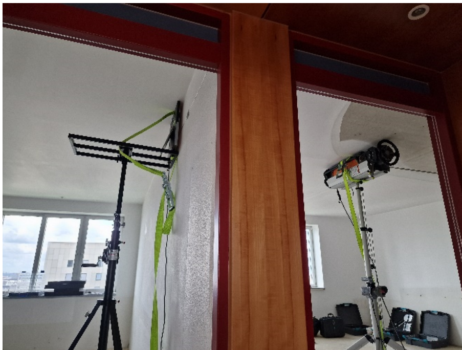
Abb. 1: Typisches Setup einer Durchstrahlungsprüfung, hier an einer Elementwand (vgl. Abschnitt 2.3). Links der Detektor nahe der Bauteiloberfläche, rechts die Röntgenröhre mit Abstand zum durchstrahlten Bauteil
