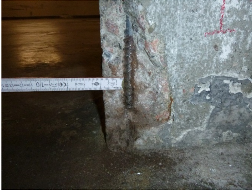
Abb. 8: Korrodierende Stützeckbewehrung vor Sanierung
