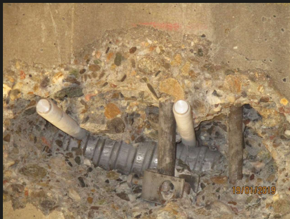
Geöffnete Stelle am Überbau
