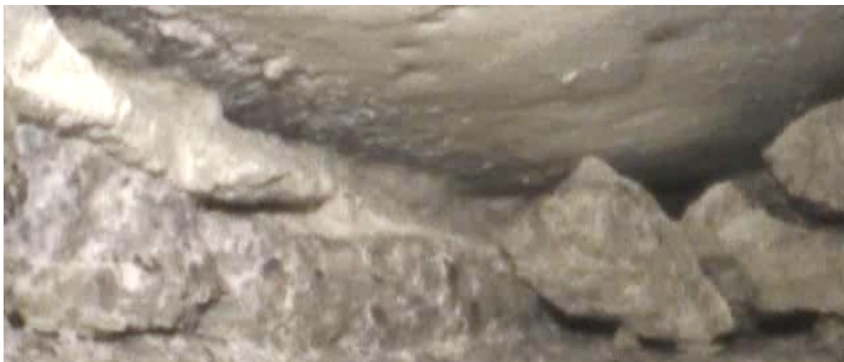
Abb. 10 Endoskopische Aufnahme des Hohlräume unter dem Walzträger. Quelle: MKP GmbH
