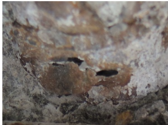
Abb. 4 Detailaufnahme des Hüllrohres im Tiefpunkt mit Korrosionslöchern. Quelle: MKP GmbH
