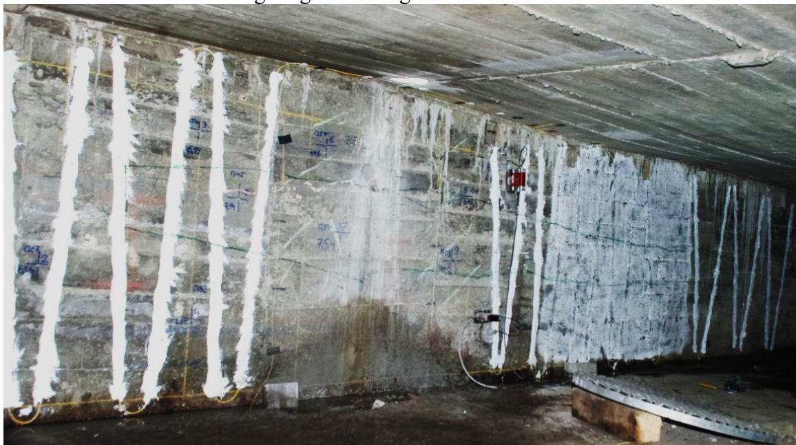
Abb. 11 Markierter Verlauf der Risse und hohl liegenden Bereichen bei Abschluss des Versuches an der Messstelle V1 sowie Darstellung der Messtechnik [2]
