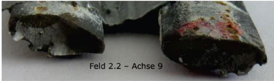
Abbildung 28: Exemplarisches Bruchbild - versprödeter Spannstahl
