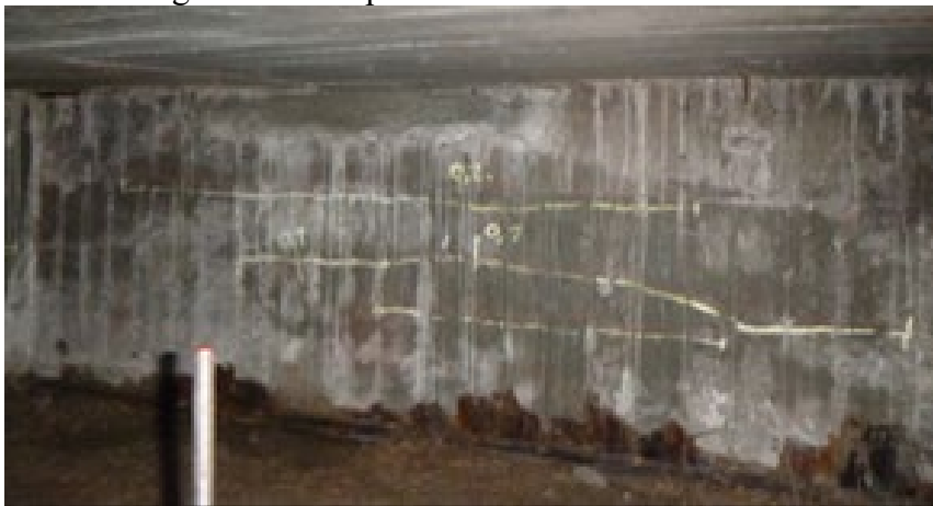
Abb. 5 Spanngliedparallele Risse (exemplarisch)
