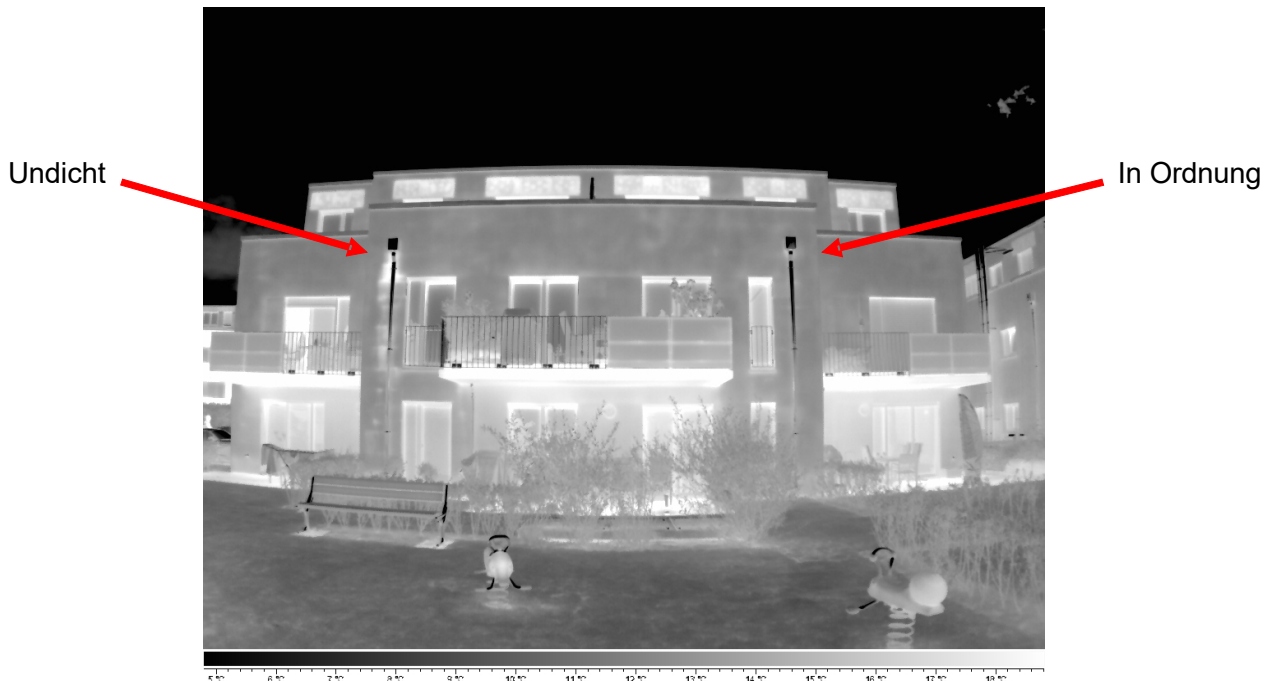
Abb 2: Das Thermogramm lässt den direkten Vergleich der schadhaften (feuchten) Zone mit einer trockenen zu. Die im Wasser gespeicherte Tageswärme lässt sich noch längere Zeit nach Sonnenuntergang nachweisen.
